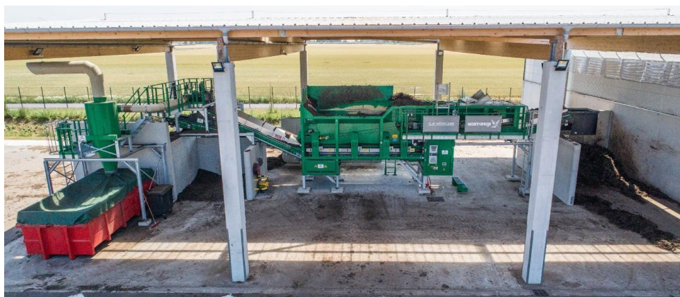
Illustration n° 29 : Installation d'affinage compost
