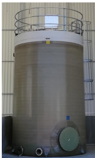
Illustration n° 22 : Cuve de stockage de soupe de biodéchets
